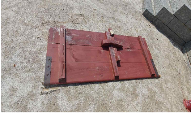
통제영 세병관 후문 파손
